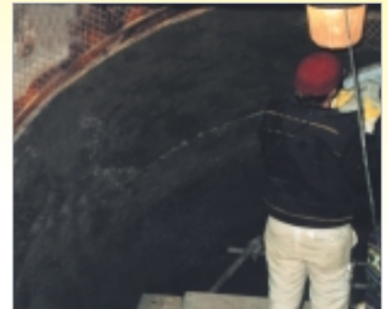
Rohrmehlleitung im Zementwerk.
