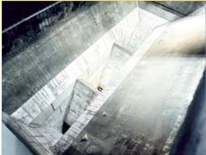
Gleitfördernde Auskleidungskombination im unteren Bereich eines Hochbunkers: mit KALEN Auskleidungen in den Schrägflächen und KALINOX in den stärker beanspruchten Ausläufen.
