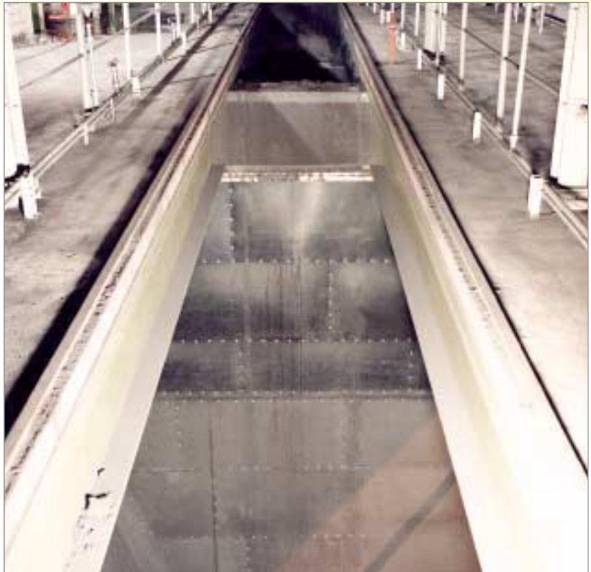
KALEN Auskleidung in einem großen deutschen Kohlekraftwerk. Das Bunkergut ist Feinkohle.
