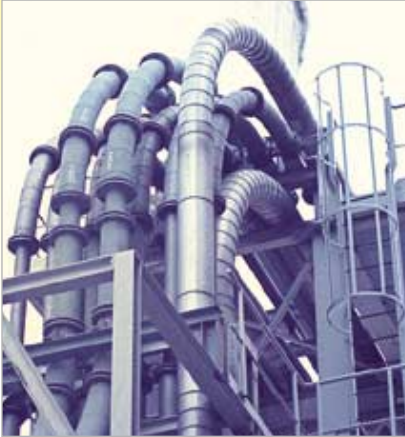
Flugascheleitungen in einem Kohlekraftwerk.
