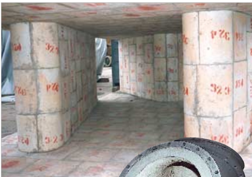
Rohgaskanal in einer Raffinerie.
